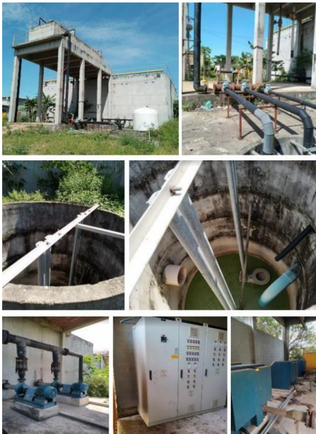
Figura 7.1.2.3 - Vista geral da entrada de esgoto bruto, EEB, Quadro de Controle Elétrico e Casa de Sopradores
