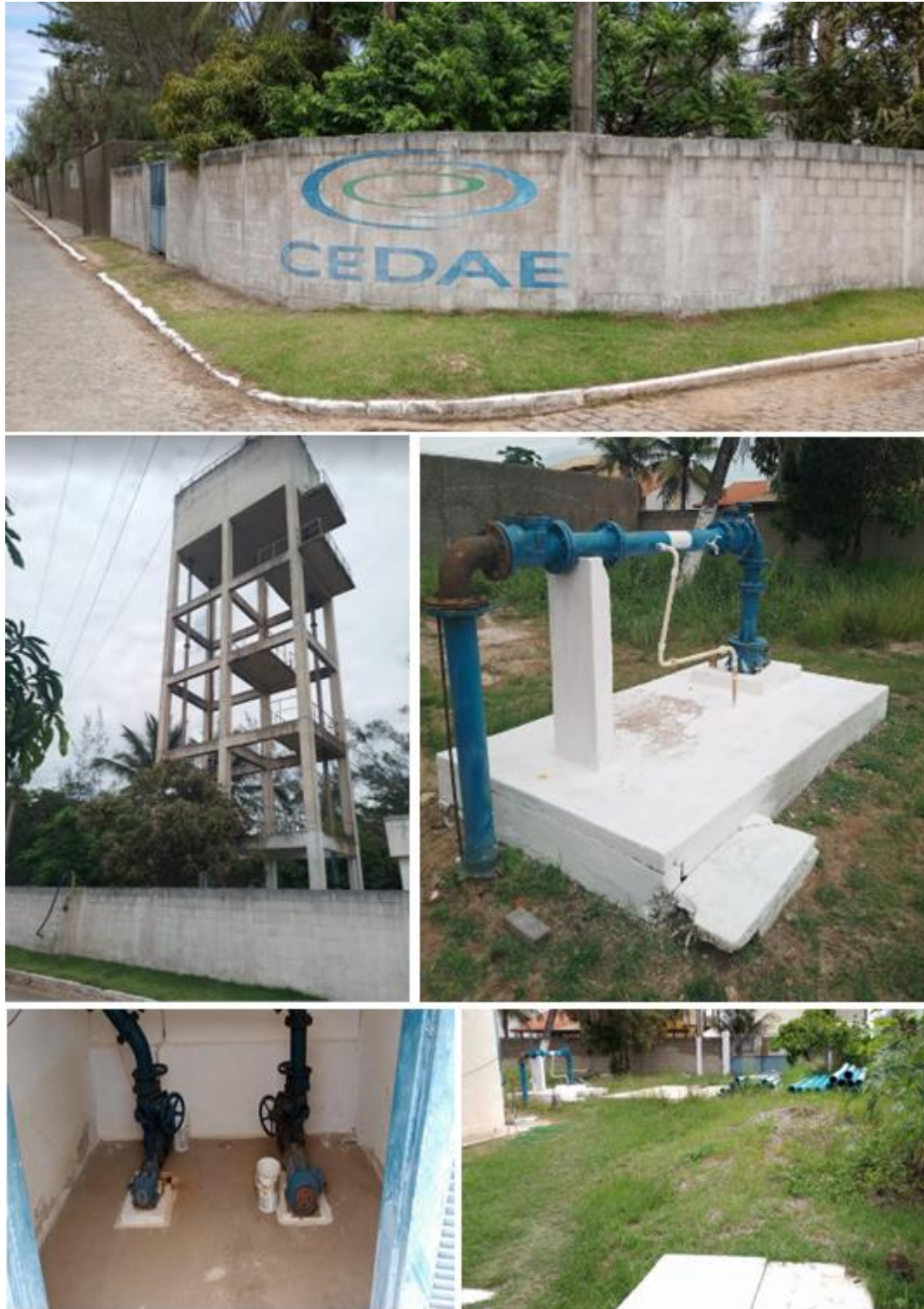
Figura 6.2.2.6 - Instalações do Poço Sesc Mineiro – Grussaí
