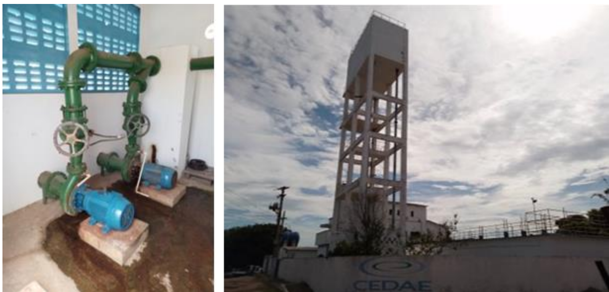
Figura 6.2.1.4 - Conjunto de elevação e reservatório elevado Sede
