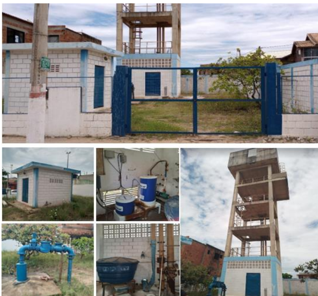
Figura 6.2.2.9 - Poço Ilha de Grussaí - Instalações
