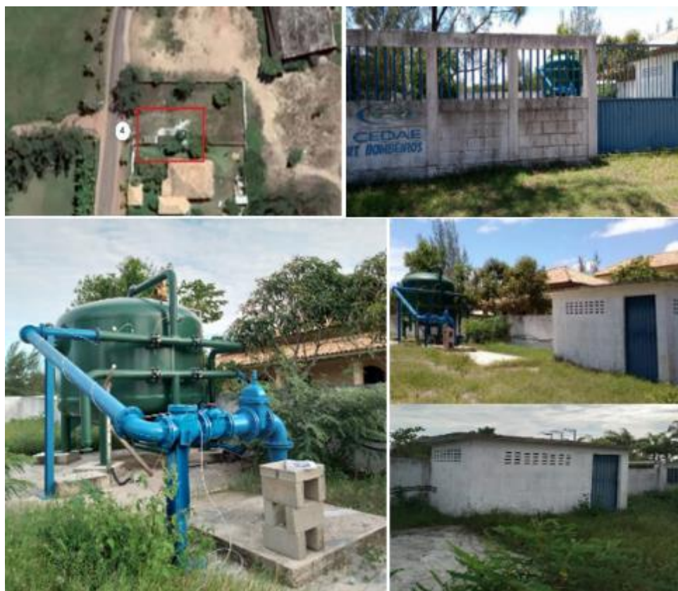
Figura 6.2.2.7 - Poço Chapéu do Sol - Bombeiros
