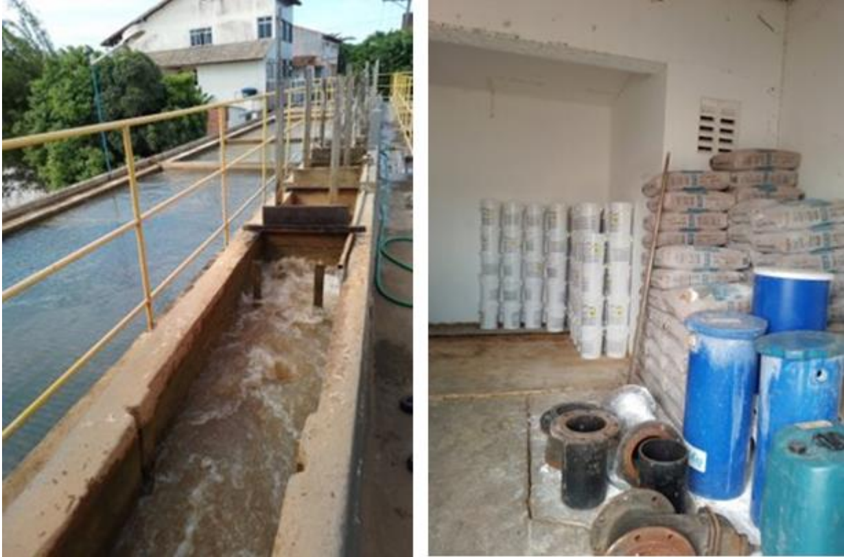
Figura 6.2.1.3 - Canal de coagulação, decantadores, filtros e casa química
